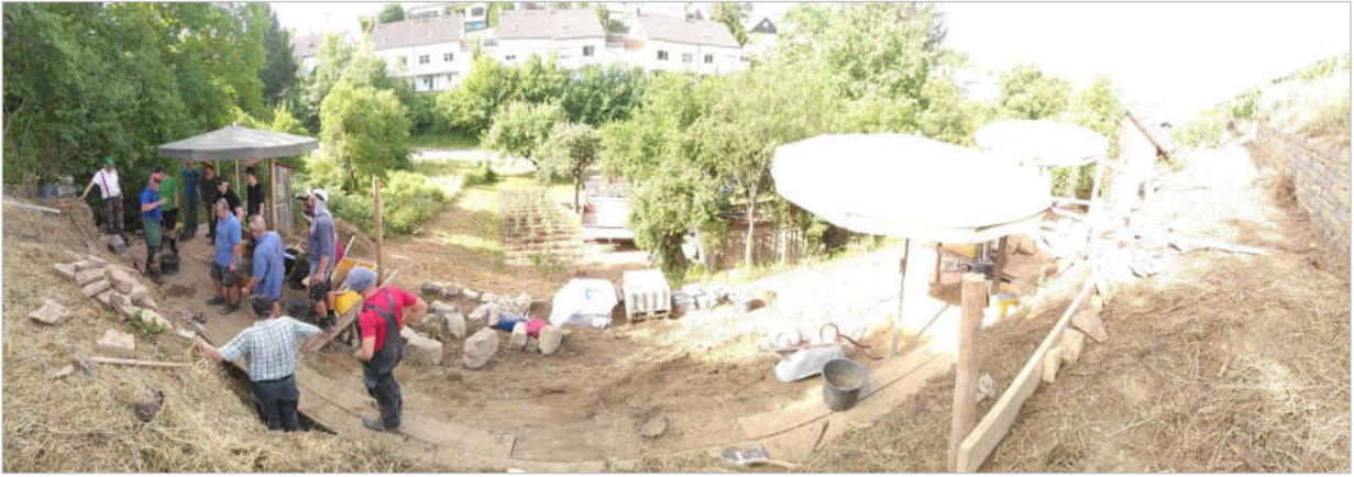
Abb. 9: Trockenmauer-Sanierungskurs in der Übersicht: Gartenbaumeister Martin Bücheler erklärt wie der Anlauf der Mauer schon beim Ausgraben des Fundamentes und durch die Anlage der Anschlagdielen mitbestimmt wird. Im Kurs wird parallel an mehreren Mauerabschnitten gleichzeitig gearbeitet. Kleine Pausen bei denen einzelne Arbeitsschritte detailliert erklärt werden, vermitteln die notwendigen Kenntnisse die kommenden Arbeiten fachgemäß auszuführen.
